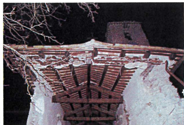
Figura 22 Chiesa di Norcia. Comportamento divaricante assunto dal cordolo sul timpano nel corso del crollo della facciata.
