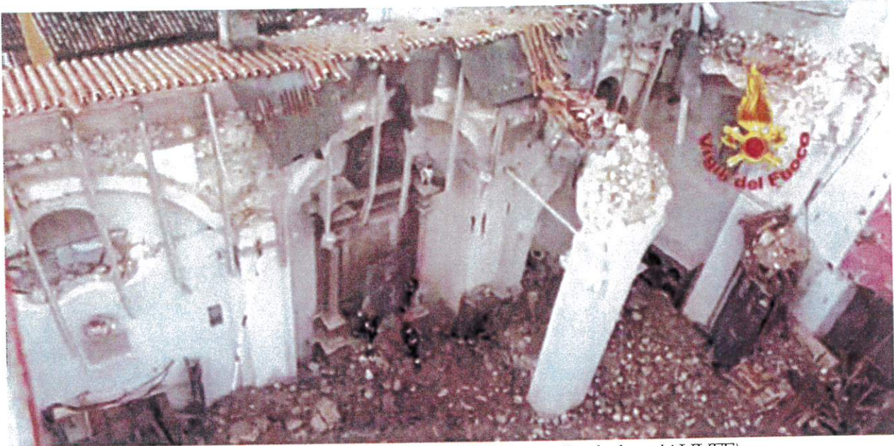
Figura 25 Chiesa di S. Maria Argentea a Norcia dopo il crollo della copertura (foto da drone dei VVFF).
