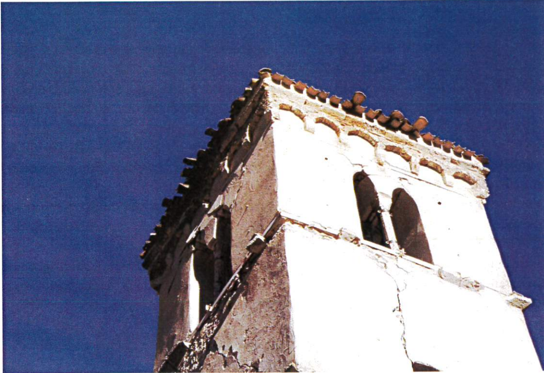
Figura 14 La cella del campanile di S. Martino dei Gualdesi, Castelsantangelo sul Nera (MC), con le due cerchiature metalliche, dopo i terremoti.
